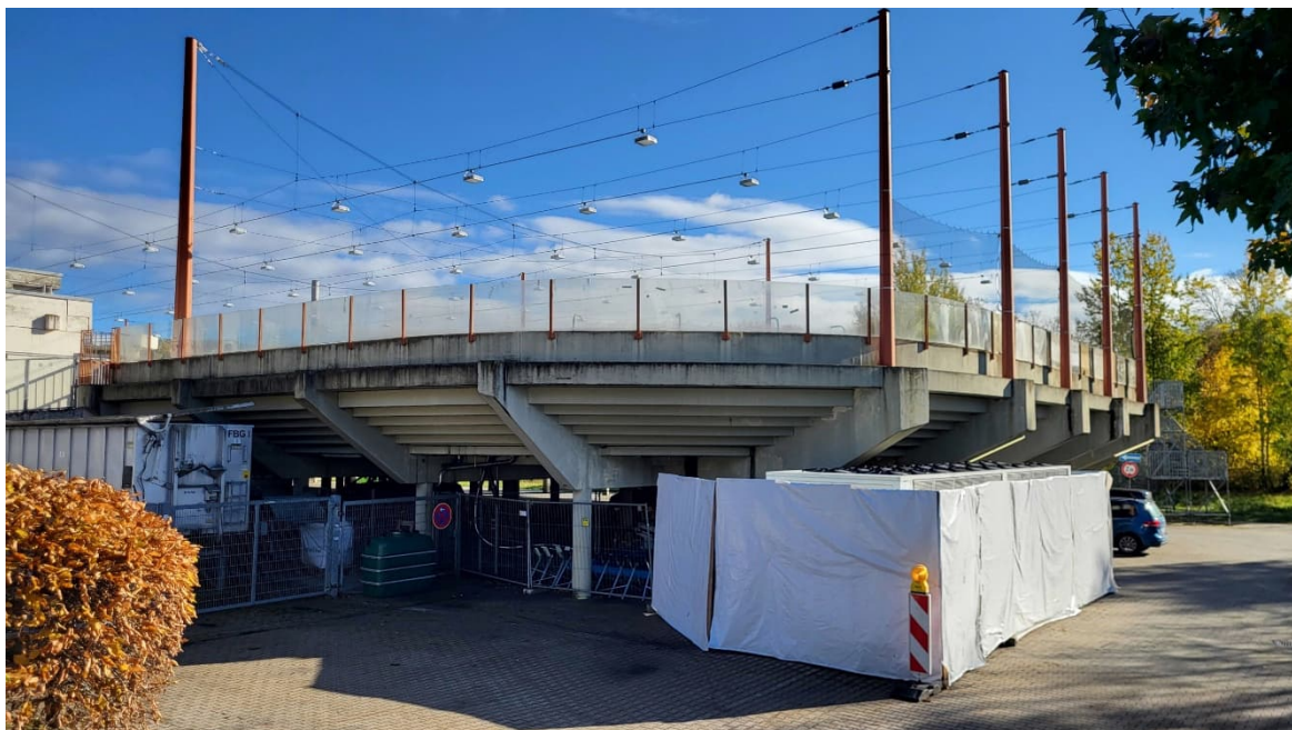
Abbildung 1: Eisstadion mit darunter liegenden Pkw-Stellplätzen, im Vordergrund rechts sind die Kälteanlagen ersichtlic
